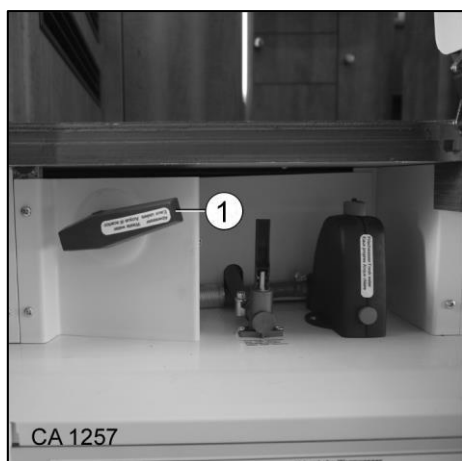
Slika 140 Praznjenje rezervoarja za odpadno vodo
