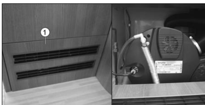
Slika 112 Grelnik pod garderobno omarico
